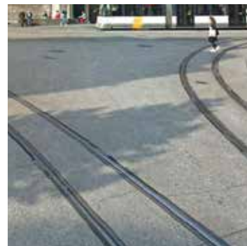
Béton désactivé du GIO et les rails du tram (même teinte que celui de la place)
