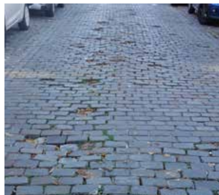
Place Saint-Denis - pavés déchaussés
