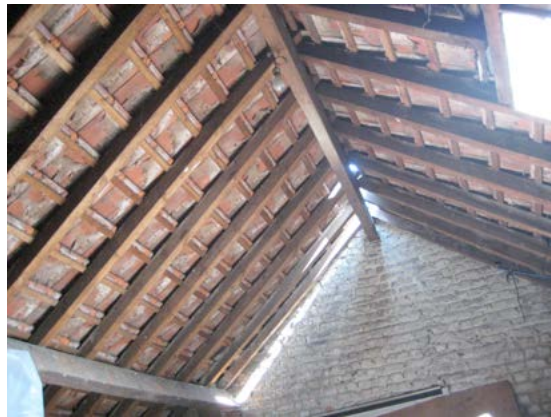
Alsebergsesteenweg 286: niet geïsoleerd en sterk geventileerd dak!
