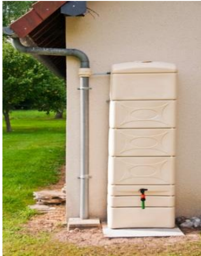
Systeem voor de recuperatie van regenwater langs de voorgevel - Bron : 123RF/delcreations
